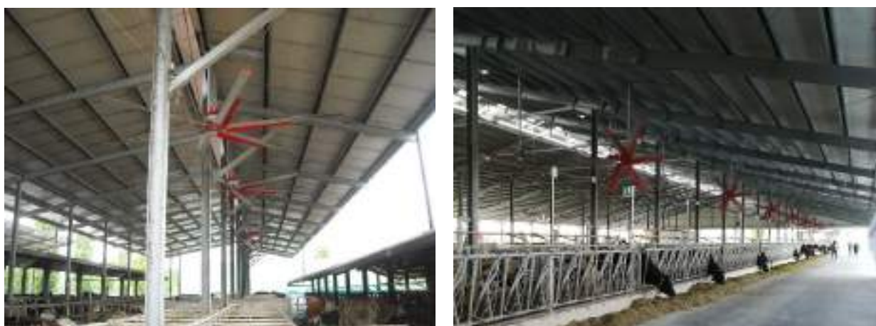
Figura 17 – Destratificatore installato in zona di riposo (a sinistra) e ventilatore ad asse con inclinazione variabile in corsia di alimentazione (a destra)
