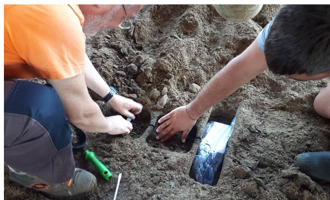
Installazione del sensore per la temperatura e umidità della lettiera
