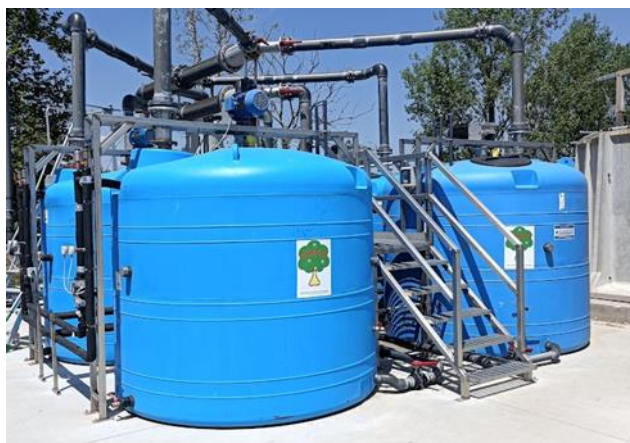
Figura 8 - Reattori in cui avviene lo stripping a lento rilascio. Nelle tubazioni che sovrastano i reattori passa l'aria che rimuove l'ammoniaca dal liquame.
