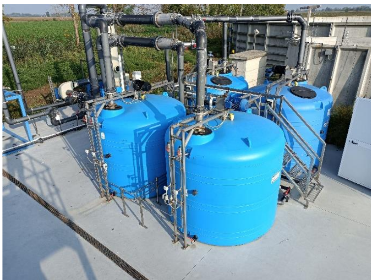
Figura 12 - I quattro reattori dell'impianto pilota sono riscaldati e miscelati in modo da favorire il rilascio dell'ammoniaca da liquame e digestato
