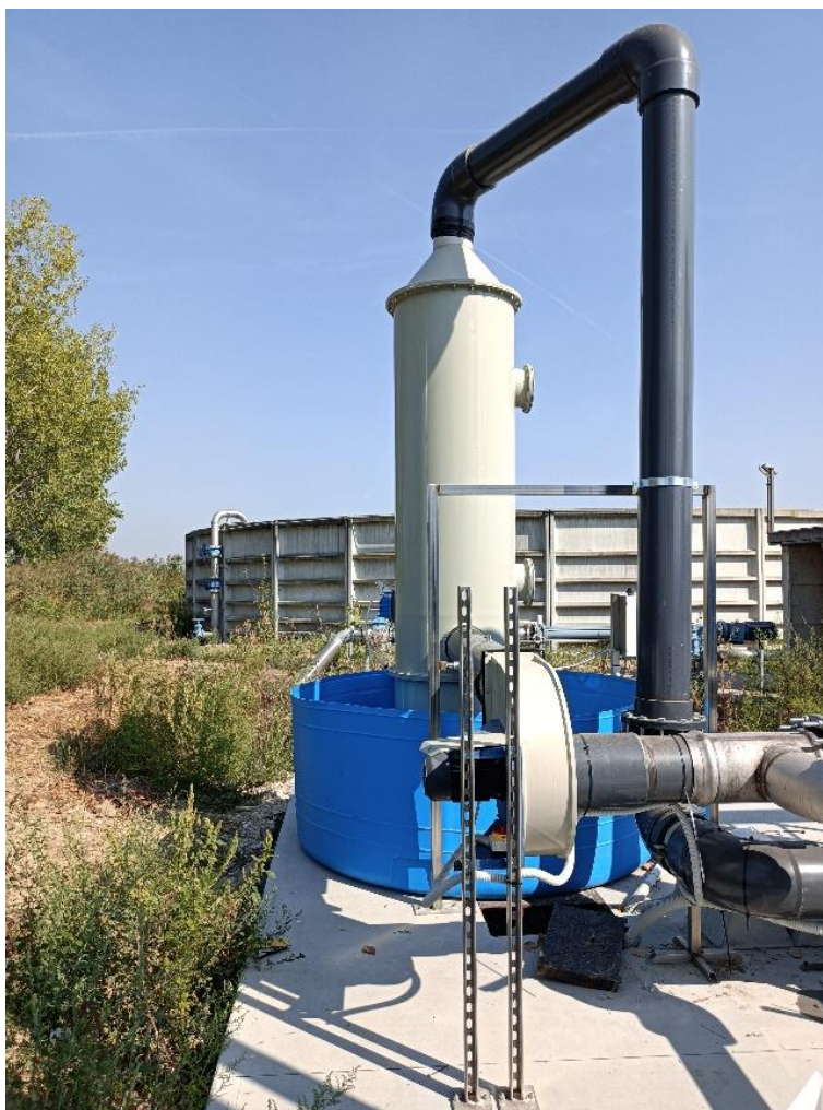
Figura 13 - La soffiante consente di far circolare l'aria attraverso lo scrubber e inviarla ai reattori dove si carica di ammoniaca
