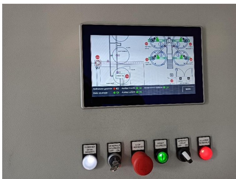
Figura 15 - L'impianto pilota è controllato attraverso un pc che consente di monitorare i diversi parametri di funzionamento del processo.
