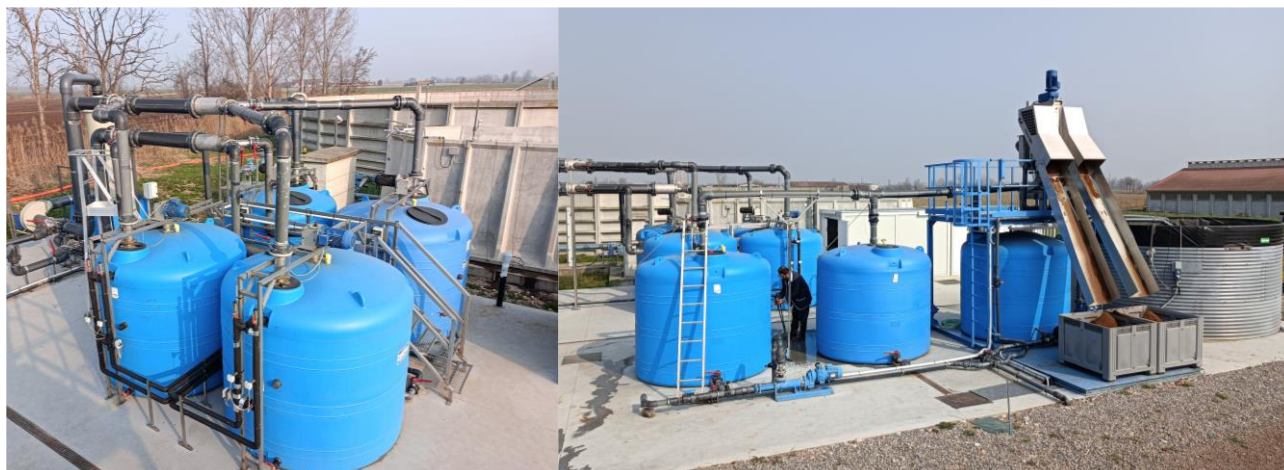
Figura 18 impianto pilota realizzato. Sulla sinistra ci sono i 4 reattori di strippaggio, sulla destra è visibile la vasca metallica di ricezione del liquame da trattare, il separatore solido-liquido e i serbatoi di stoccaggio della frazione liquida
