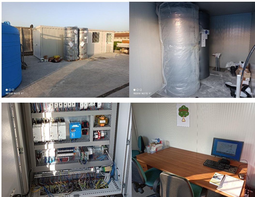
Figura 5 – container per locale riscaldamento dell'acqua e quadro di controllo. In alto a sinistra esterno dei container. In alto a destra posizionamento del contenitore per l'acqua calda. In basso a sinistra quadro elettrico. In basso a destra pc per il controllo remoto.
