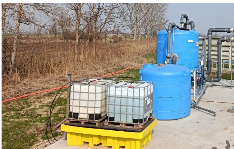
Figura 14 – Contenitori per l'acido solforico (a sinistra) e per il solfato d'ammonio (a destra)
