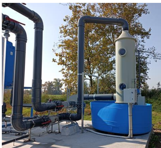
Figura 9 - Scrubber in cui avviene il contro lavaggio con l'acido solforico dell'aria carica di ammoniaca proveniente dai reattori di stripping. Una soffiante genera il flusso d'aria in un circuito chiuso che collega reattori e scrubber tramite tubazioni in PVC.
