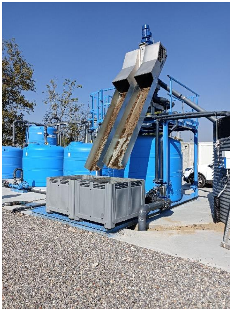
Figura 11 - Il liquame prima del trattamento subisce un trattamento di separazione dei solidi
